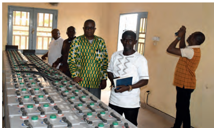
Visite du local technique de la mini-centrale solaire PV de Basgana
